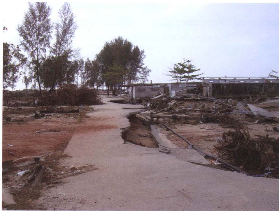
รูปที่ 3-8 การกัดเซาะถนนและบ้านเรือนในบริเวณบ้านน้ำเค็ม
