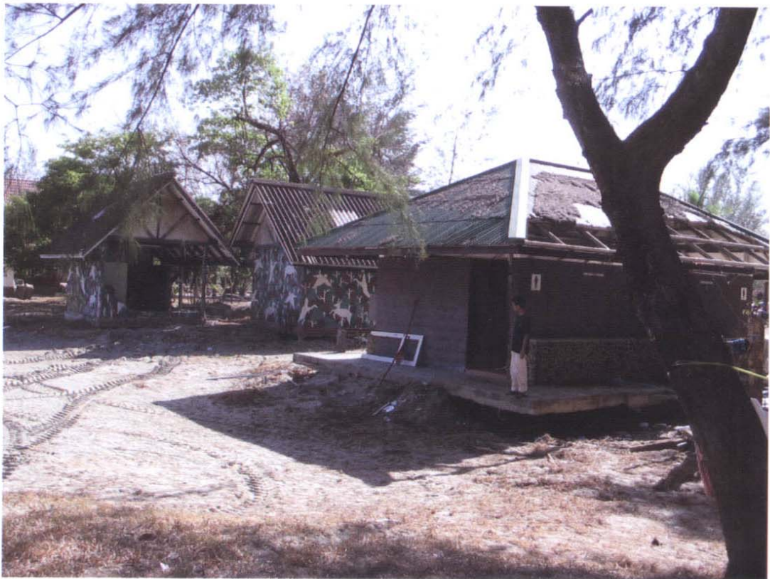
รูปที่ 2-5 ความเสียหายของอาคารซึ่งถูกคลื่นกัดเซาะพื้นที่ทรายได้ฐานอาคารออกไป
